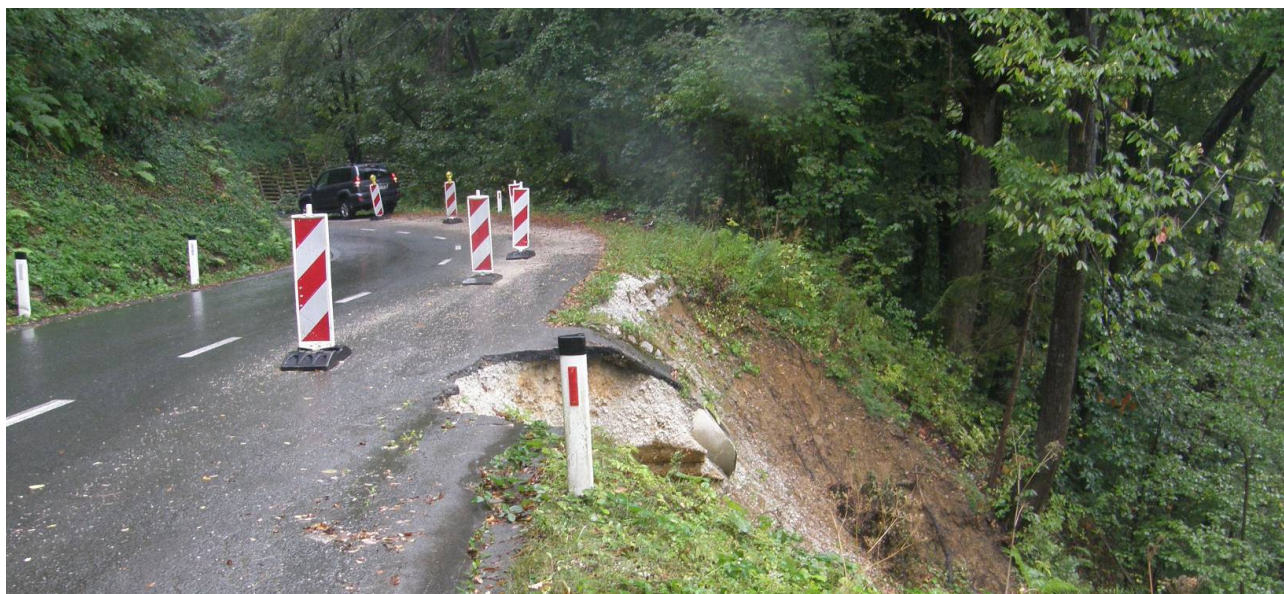
Slika 12: Regresivna erozija zaradi velike kinetične energije na prehodu na naravno pobočje.
