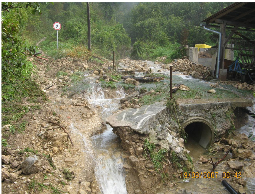
Slika 11: Zamašitev prepusta zaradi vpliva zajeze na vtoku in posledično zamašitve s plavinami in plavjem.
